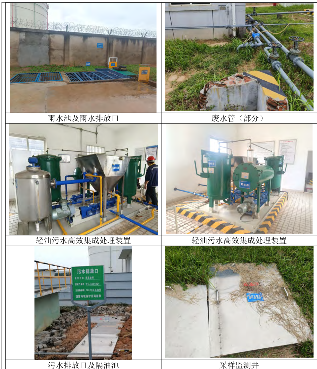
图3-2 废水治理设施现场照片
